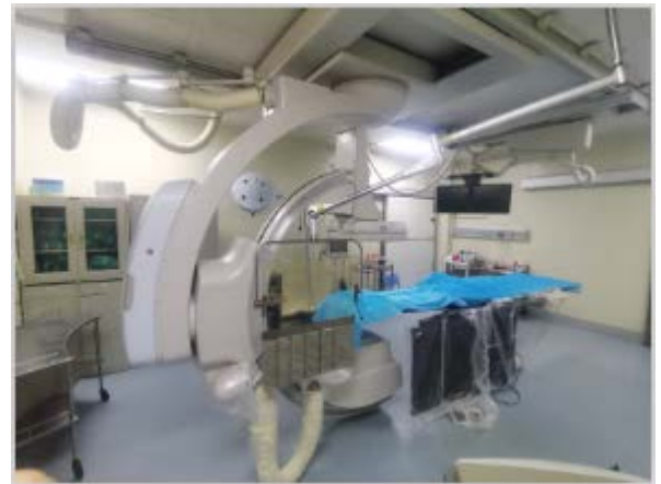
本项目 DSA 机房内部
